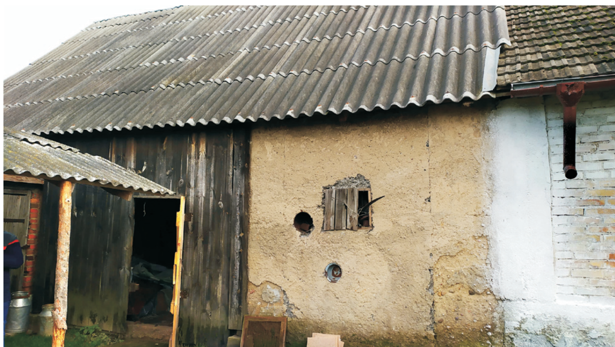
Ryc. 9. Budynek inwentarski w Kołakach Kościelnych; fot. E. Milewska Fig. 9. The cowhouse in Kołaki Kościelne; photo by: E. Milewska
