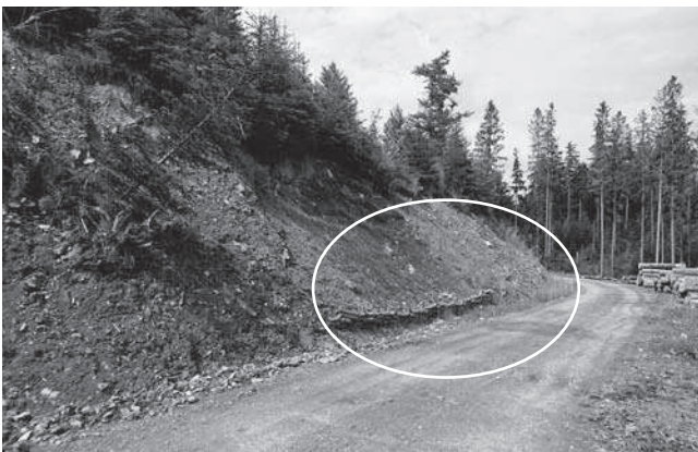
Rys. 7. Widok skarpy w lipcu 2019.; wyraźnie widoczna różnica pomiędzy powierzchnią skarpy wzmocnionej a sąsiednią nieumocnioną
