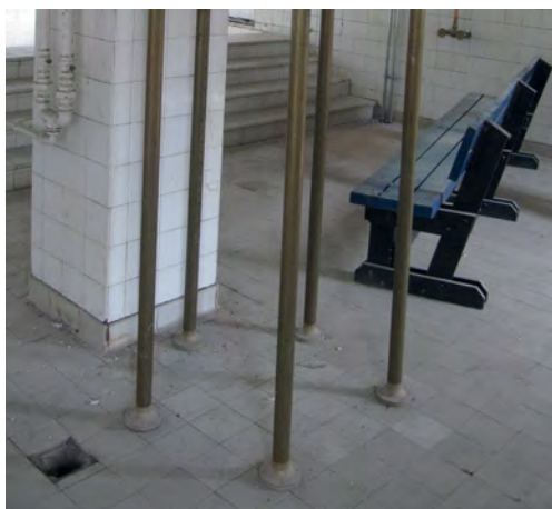
Rys. 2. Posadzka z płytek ceramicznych
