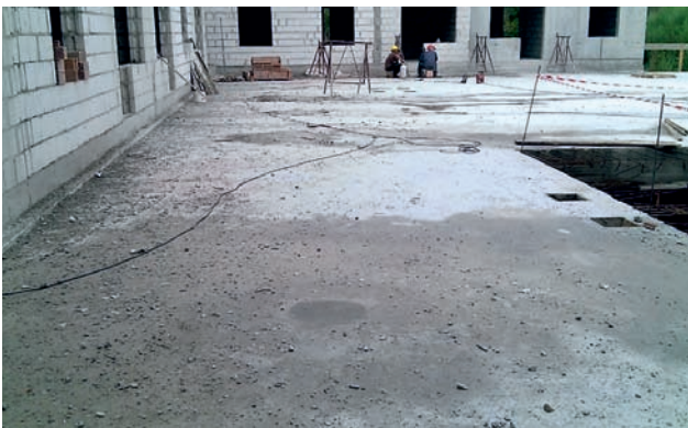
Rys. 2. Fragment płyty stropowej o niskiej wytrzymałości. Fig. 2. The fragment of the ceiling slab of a low strength.
