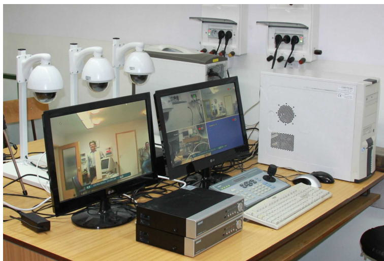
Rys. 4. Stanowisko do badania systemów CCTV i kamer obrotowych PTZ
