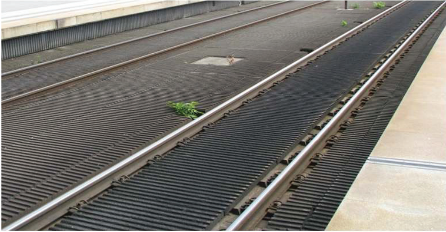
Rys. 8. Widok ogólny tłumików torowych z betonu porowatego, stosowanych na kolejach niemieckich DB Foto – W. Oleksiewicz
