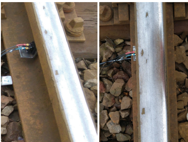
Rys. 3. Wada 221 – uszkodzenie powierzchni tocznej na linii kolejowej nr 213 Reda – Hel [fot. autorów]
