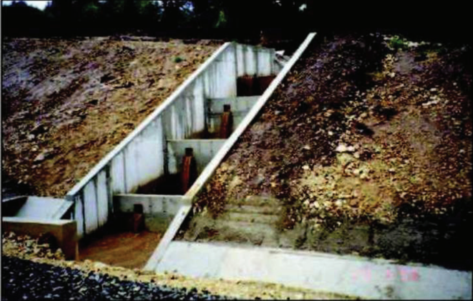
Rysunek 6. Kanał odpływowy z progami rozpraszającymi energię spływającej wody - linia LGV Méditerranée
