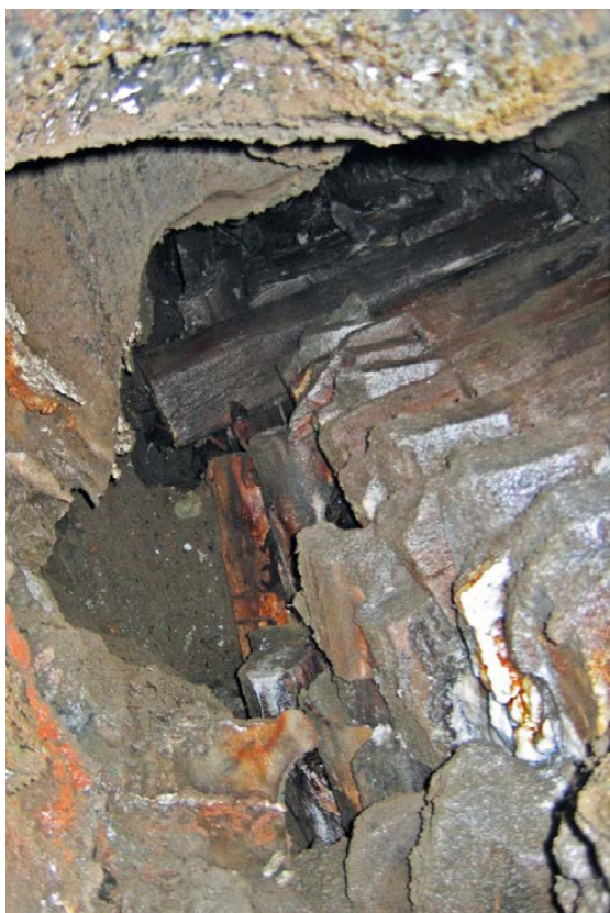
Ryc. 13. Fragment szybu Regis na odcinku poniżej IV poziomu. Rozługowania górotworu powstałe w wyniku działania nienasyconych wód w czasie katastrofy wodnej z lat 1868-1879. Stan na lipiec 2004. Fot. J. Przybyło.
