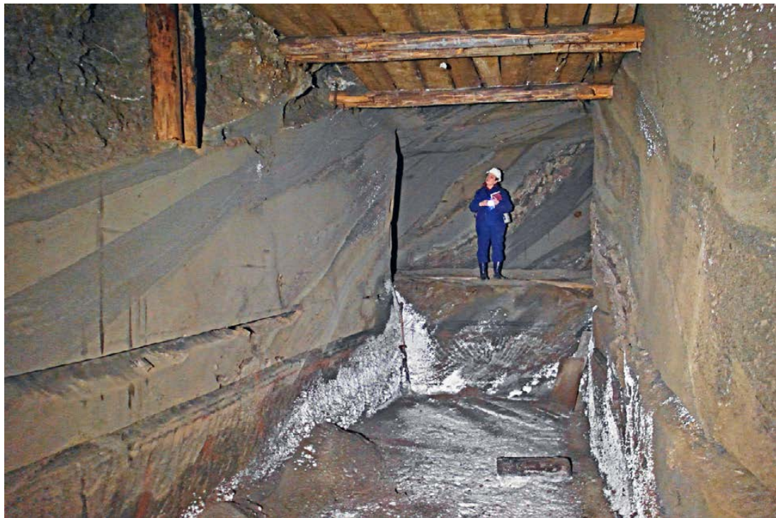
Ryc. 12. Wyrobisko zlokalizowane przy poprzeczni Colloredo 2. Widoczne podługowania ociosu w wyniku działania nienasyconych wód w czasie katastrofy wodnej z lat 1868-1879 Stan na listopad 2014.
