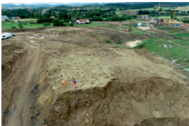
Rys. 6. Łączenie konektorów w sieć strzałową Fig. 6. Joining connectors into a blasting network
