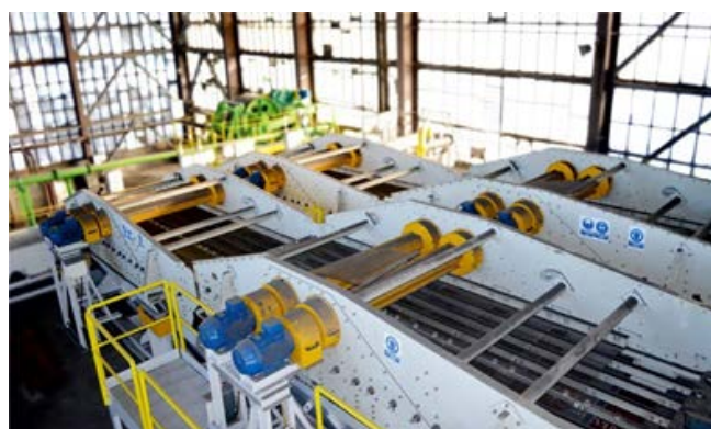
Fot. 1. Dwa ciagi posobnie posadowionych przesiewaczy PWP1 – 2,2x5,25 firmy Progress Eco ( www.progress-technika.pl )
