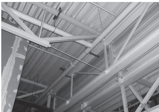
Rys. 5. Stężenie jednostronne dźwigara skrajnego – zgodnie z projektem powinien być kątownik
