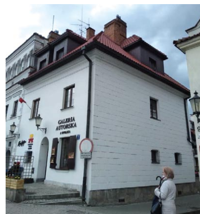
Rys. 4. Ocieplenie zewnętrzne na ścianie bocznej zabytkowej kamienicy w Kazimierzu Dolnym nad Wisłą (fot. M. Rogalska)
