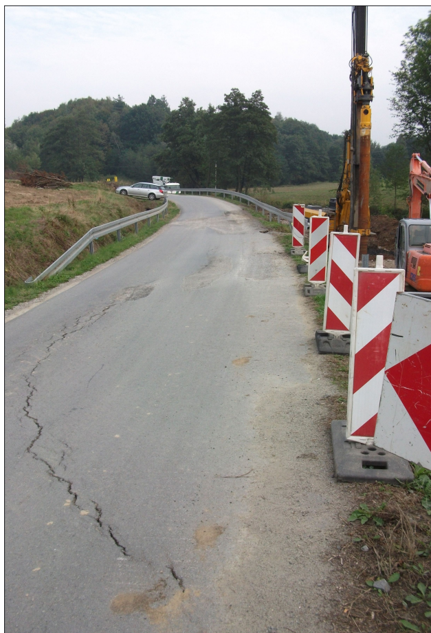
Rysunek 5. Pęknięcia nawierzchni widoczne na drodze od strony skarpy potoku
