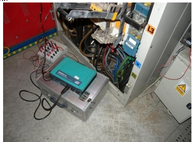
Rys. 3. Podłączenie analizatora parametrów sieci Memobox 800
