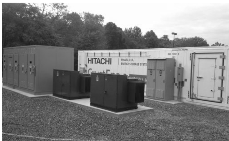
Rys. 4.5. Bateria CrystEna wykorzystana w Somerdale, New Jersey [5]
