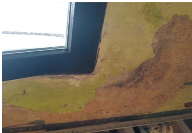
Rys. 1. Grzyby powstały na skutek źle zaizolowanej ściany piwnicy
