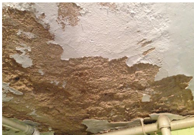
Rys. 2. Odpadający tynk na skutek działania grzybów
