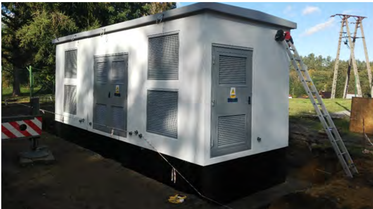
Zdj. 5. Elektrownia Rosnowo. Widok po modernizacji. Budynek (stacja) transformatorów blokowych
