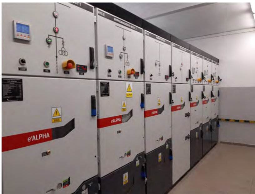
Zdj. 4. Elektrownia Rosnowo. Widok po modernizacji. Rozdzielnica SN 15 kV
