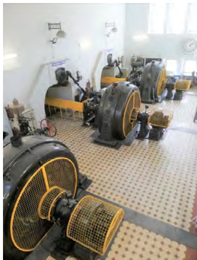
Zdj. 2. Elektrownia Rosnowo. Widok po modernizacji. Hala maszyn
