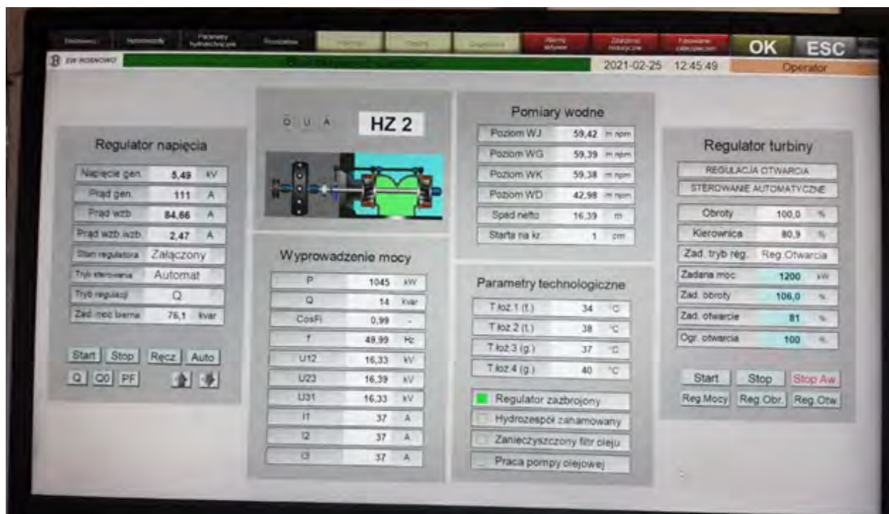
Zdj. 7. Elektrownia Rosnowo. SCADA lokalna, ekran hydrozespołu nr 2
