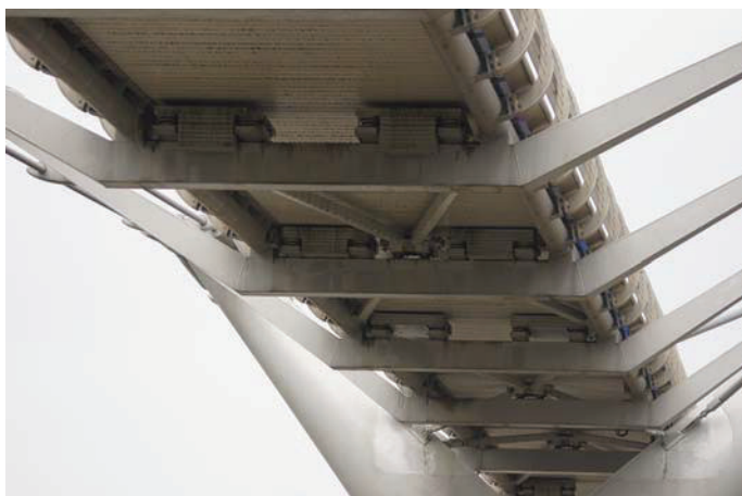
Fot. 4. System tłumików kładki Millennium Bridge
