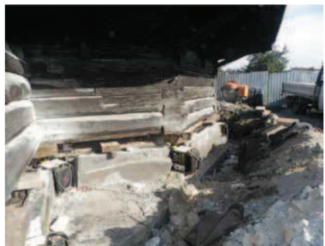
Fot. 11. Siłowniki zabudowane poniżej drewnianych zabytkowych elementów konstrukcji budynku kościoła Photo 11. Servomotors placed below the historical wooden construction elements of the church
