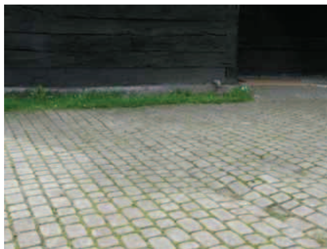
Fot. 3. Deformacje nieciągłe nawierzchni terenu przy budynku kościoła
