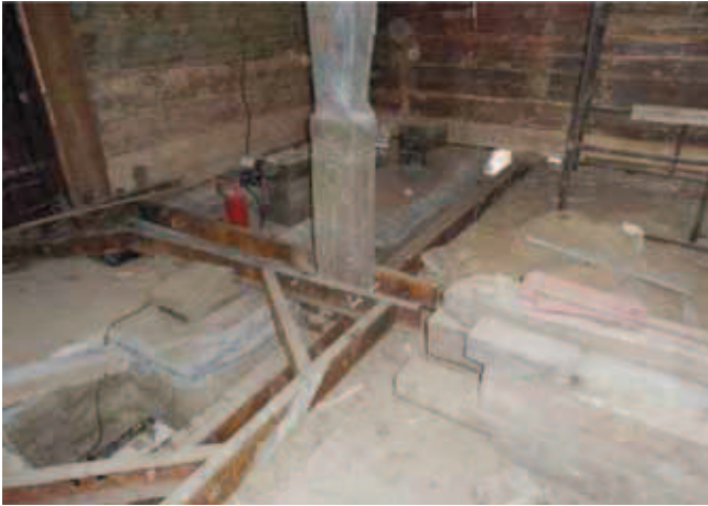
Fot. 12. Przykłady stalowych wzmocnień poprowadzonych pod drewnianą konstrukcją budynku
