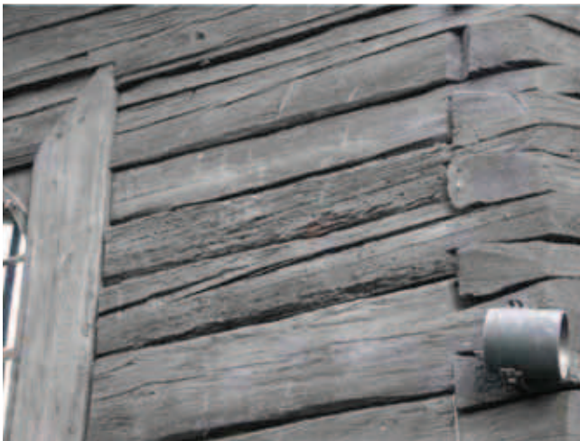
Fot. 6. Rozluźnienie belek wypełnienia ściany prezbiterium Photo 6. Beams loosening of wall filling of the presbytery
