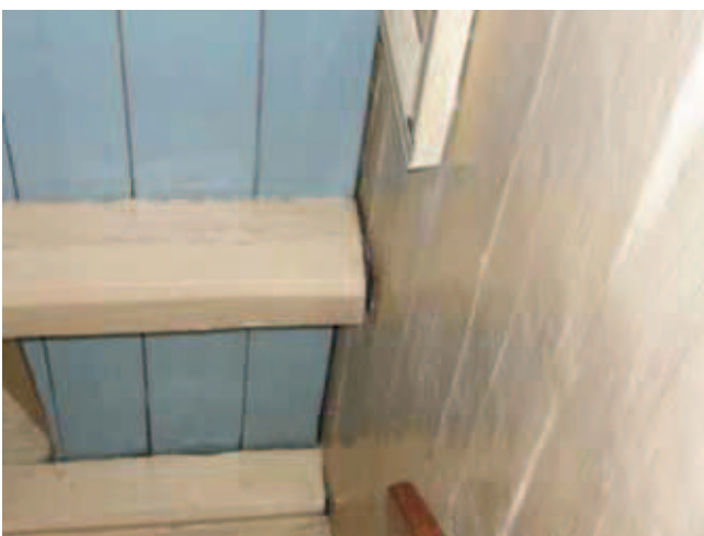
Fot. 7. Ślady wysunięcia się belek nośnych dolnego podestu chóru ze ściany kościoła Photo 7. Displacement traces of carrying beams of lower choir platform from the church wall
