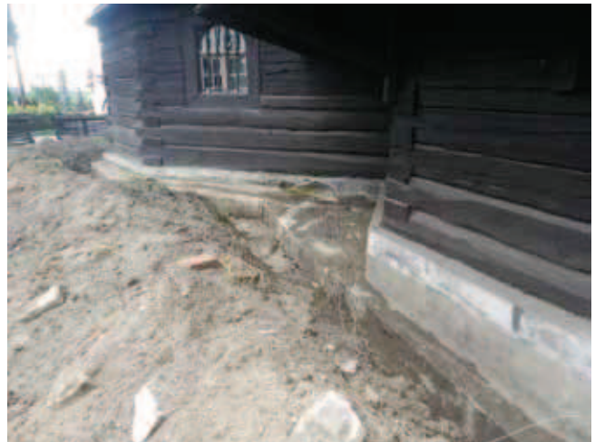
Fot. 9. Pustki pod żelbetową płytą Photo 9. Voids under reinforced concrete slab
