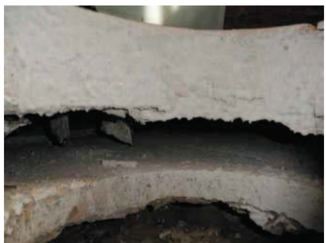
Fot. 10. Rozwarstwienie między żelbetową płytą grubości 12 cm a nową warstwą betonu o średniej grubości 15 cm Photo 10. Stratification between the reinforced concrete slab with thickness of 12 cm and a new concrete layer with an average thickness of 15 cm
