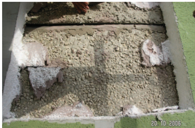
Rys. 6b. Odstąpienie warstwy docieplenia w obszarze złącza ZWO-ZWO-S
