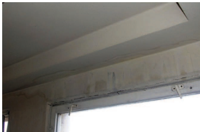
Rys. 5b. Zawilgocenia tynku w obszarze nadproża okiennego w obrębie złącza stropodachu w budynku, po dociepleniu ścian zewnętrznych
