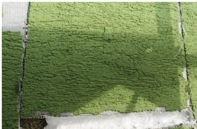
Rys. 6a. Uszkodzenie warstwy fakturowej i zbrojącej na skutek wadliwego wykonania docieplenia w obszarze złącza ZWO-ZWO-S
