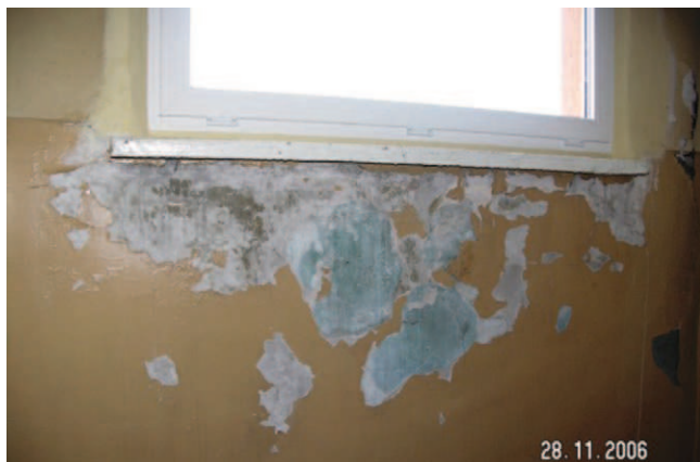
Rys. 5a. Złuszczenia farby i zawilgocenia tynku ściany w obrębie parapetu w budynku po wadliwym dociepleniu ścian zewnętrznych
