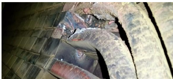
Rys. 5. Uszkodzone ceki uzwojenia stojana
