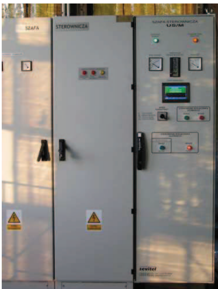
Rys. 1. Widok szaf sterowniczych układu sterowania maszyny wyciągowej [1] Fig. 1. Control system of the winding machine [1]
