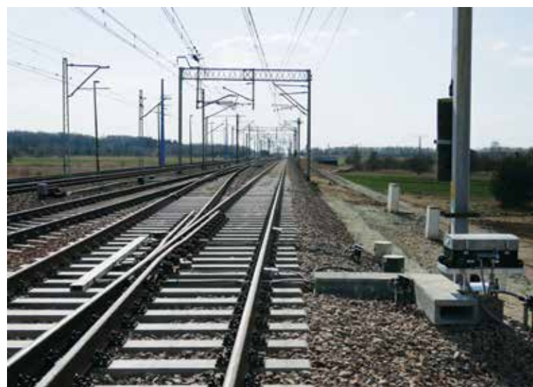
Fot. 2. Krzyżownica rozjazdu R1200, 1:18,5; widoczne siłowniki, kontroler rozprucia, transformatory separacyjne ogrzewania rozjazdów ARES, skrzynki połączeniowe JVA oraz agregat hydrauliczny HPU Źródło: archiwum własne.
