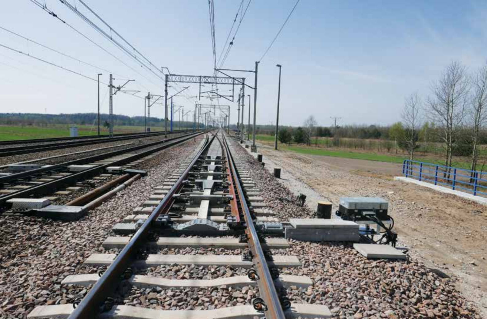
Fot. 1. Zwrotnica rozjazdu R1200, 1:18,5; na zdjęciu widoczne są podrozjazdница zespolona – MOT (pierwsze zamknięcie), zamknięcia 2, 3 i 4 oraz ściąg iglicowe pomiędzy zamknięciami, po prawej stronie toru zainstalowany jest agregat hydrauliczny – HPU Źródło: archiwum własne.
