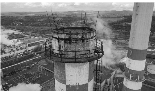
Fot. 10. Kontrola stanu technicznego komina w zakładzie przemysłowym (źródło: http://udrzbaopodniku.cz/hlavni-menu/artikuly/artikul/article/bezpilotni-letadla-pri-sprave-budov-a-prumyslovych-arealu/ )
