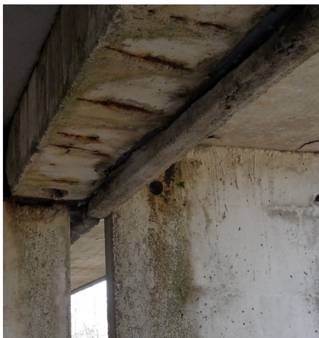
Rys. 7. Skorodowane złącze poziome ZWO-S-ZWO, autor: D. Tomaszewicz
