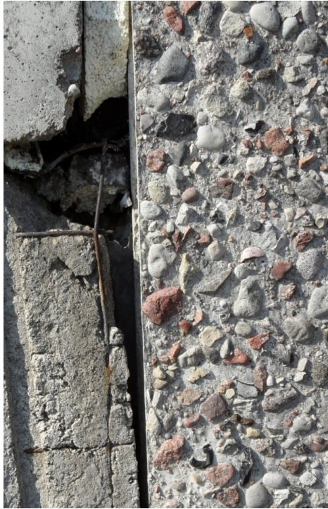
Rys. 1. Stan siatki zbrojeniowej zabetonowanej w warstwie fakturowej, autor: D. Tomaszewicz
