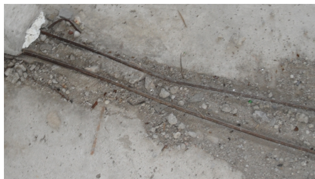
Rys. 5. Odkryte pręty zbrojeniowe w progu otworu drzwiowego, autor: D. Tomaszewicz
