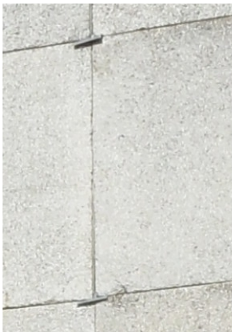
Rys. 10. Widok łączenia płyt w ścianie szczytowej, autor: D. Tomaszewicz
