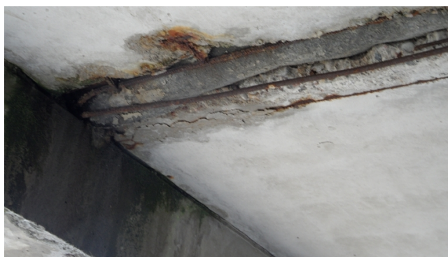
Rys. 4. Skorodowane, odkryte zbrojenie w stropie, autor: D. Tomaszewicz
