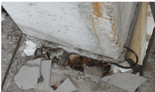
Rys. 6. Uszkodzenie płyty stropowej w okolicy komina, autor: D. Tomaszewicz
