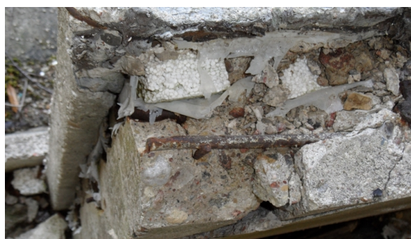
Rys. 3. Widok odkrytego pręta kotwiącego w zewnętrznej ścianie trójwarstwowej, autor: D. Tomaszewicz
