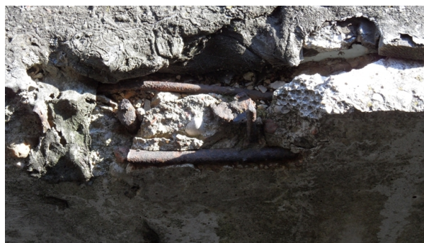
Rys. 2. Stan zbrojenia warstwy konstrukcyjnej w ścianie trójwarstwowej, autor: D. Tomaszewicz
