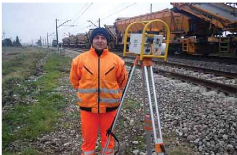
Fot. 7. Operator ASO obok radiowego sygnalizatora akustyczno-optycznego
