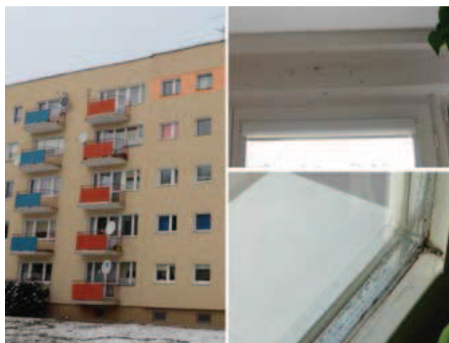
Rys. 7. Prawidłowo wykonana termomodernizacja i skutki uboczne eksploatacji niektórych lokali: a) elewacja budynku (Wk-70), b) grzyby na nadprożu, c) woda na szybie i ramie okiennej od wnętrza pomieszczenia
