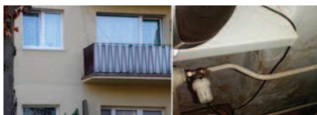
Rys. 8. Prawidłowo wykonana termomodernizacja i skutki uboczne eksploatacji niektórych lokali: a) elewacja budynku (budownictwo tradycyjne), b) wilgoć z lokalnymi ogniskami krystalizacji soli (złuszczona powłoka malarska)
