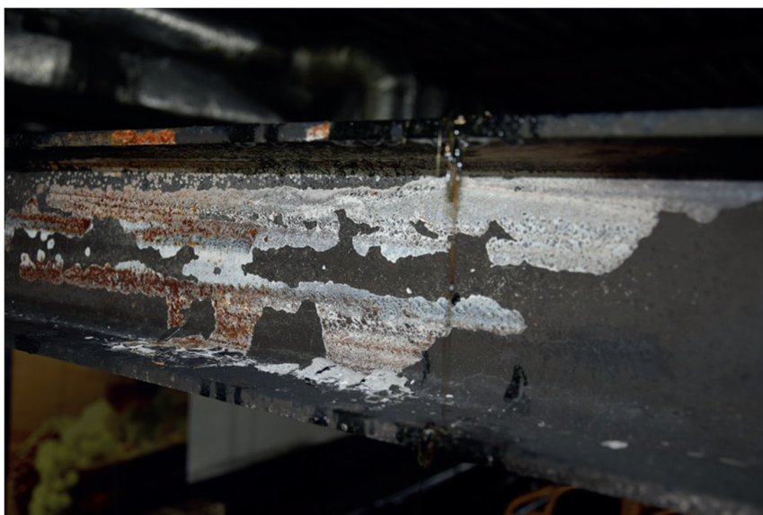
Rys. 2. Uszkodzony pas dolny kratownicy
