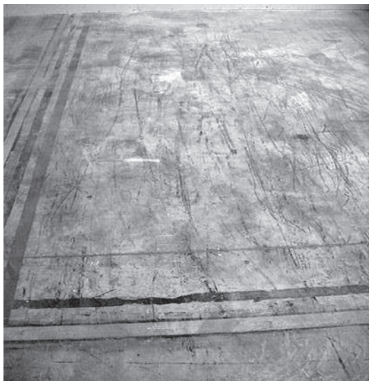
Rys. 1. Zabrudzona i uszkodzona powierzchniowo posadzka betonowa
