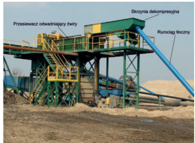
Fot. 3. Przesiewacz ze skrzynią dekompresyjną przyjmującą zawiesinę z koparki ssącej. Wariant III Photo 3. Screen with decompression box receiving slurry from suction excavator (option III)
