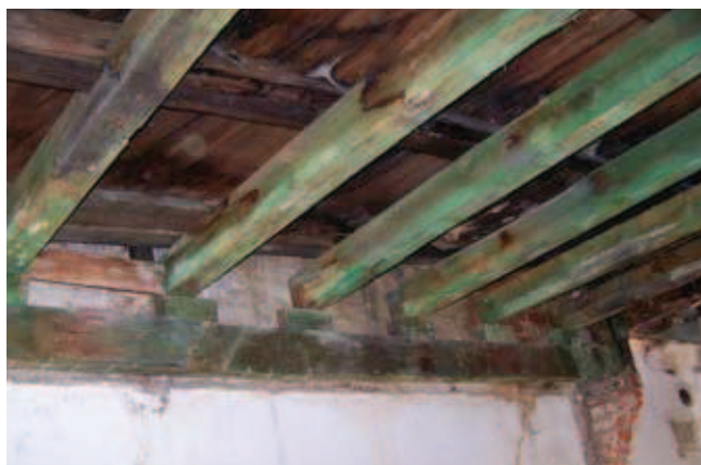
Rys. 9. Zawilgocony fragment płaskiej części dachu, fot. J. Misiewicz, 2007
