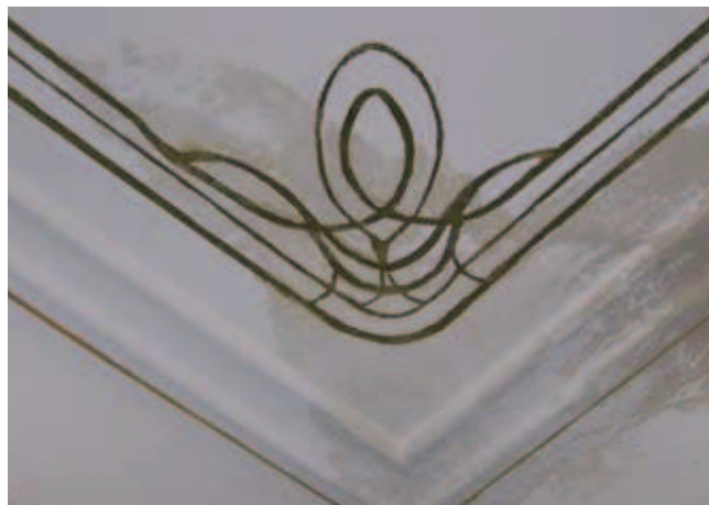
Rys. 12. Błędnie odtworzone złączenia podczas remontu w 2004 roku, fot. J. Misiewicz, 2007
