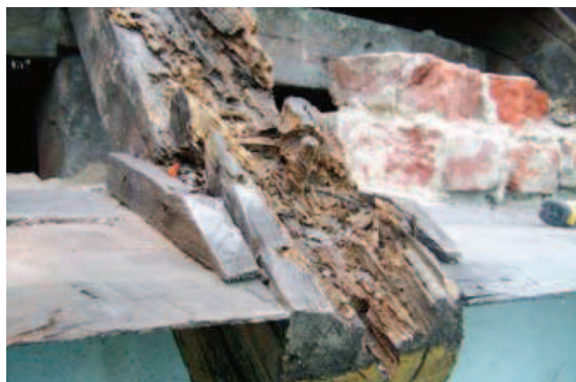
Rys. 10. Zniszczony fragmentu krokwi w wyniku działania owadów i grzybów, fot. J. Misiewicz, 2007
