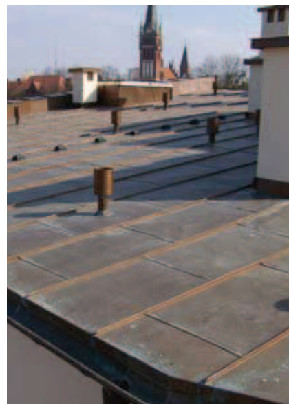
Rys. 22. Dachy płaski pokryty blachą miedzianą, fot. J. Misiewicz, 2008
