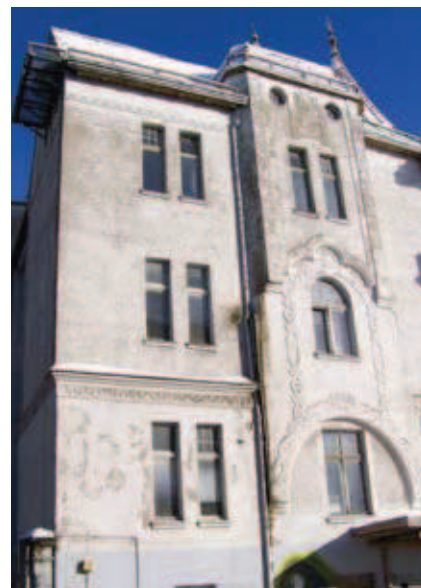
Rys. 4. Elewacja od strony ul. Mrongowiusza przed renowacją, fot. J. Misiewicz, 2007
