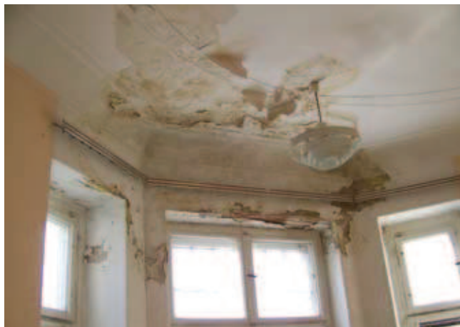
Rys. 11. Szkody spowodowane przeciekami, fot. J. Misiewicz, 2007
