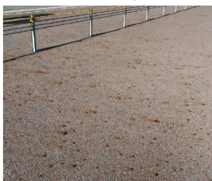
Photo 1. The asphalt pavement damages Fot. 1. Uszkodzenia nawierzchni
