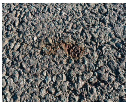
Photo 2. Rust spot on the asphalt pavement Fot. 2. Rdzawe plamy w nawierzchni
