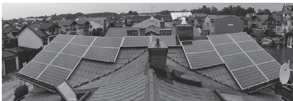
Rys. 2. Badana instalacja fotowoltaiczna o mocy zainstalowanej 5,5 kWp, zintegrowana z dachem, zlokalizowana w Słupsku
