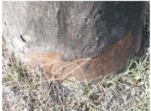
Ryc. 4. Brak powłoki oraz widoczna utrata przyczepności izolacji do podłoża (Krakowiak i in., 2013)
