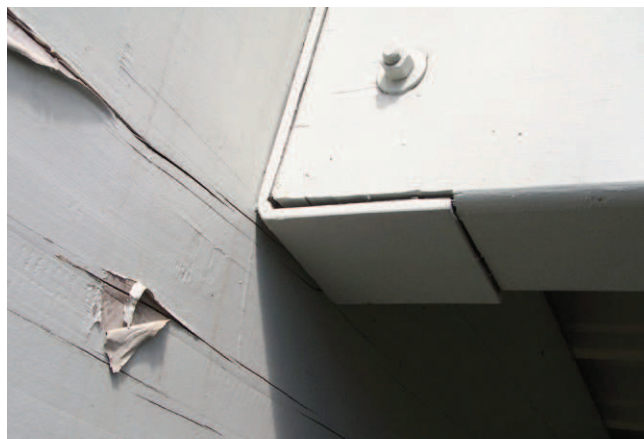
Rys. 6. Połączenie tęznika z rygłem. Widoczne spękania rygla oraz łuszczenie się powłoki malarskiej
