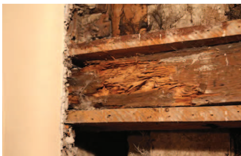
Rys. 7. Korozja biologiczna istniejących belek stropowych
