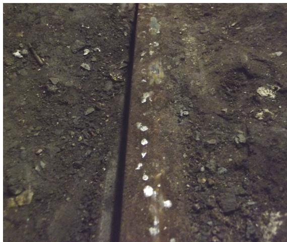
Rys. 6. Stan nawierzchni szyn podczas badań [3]
