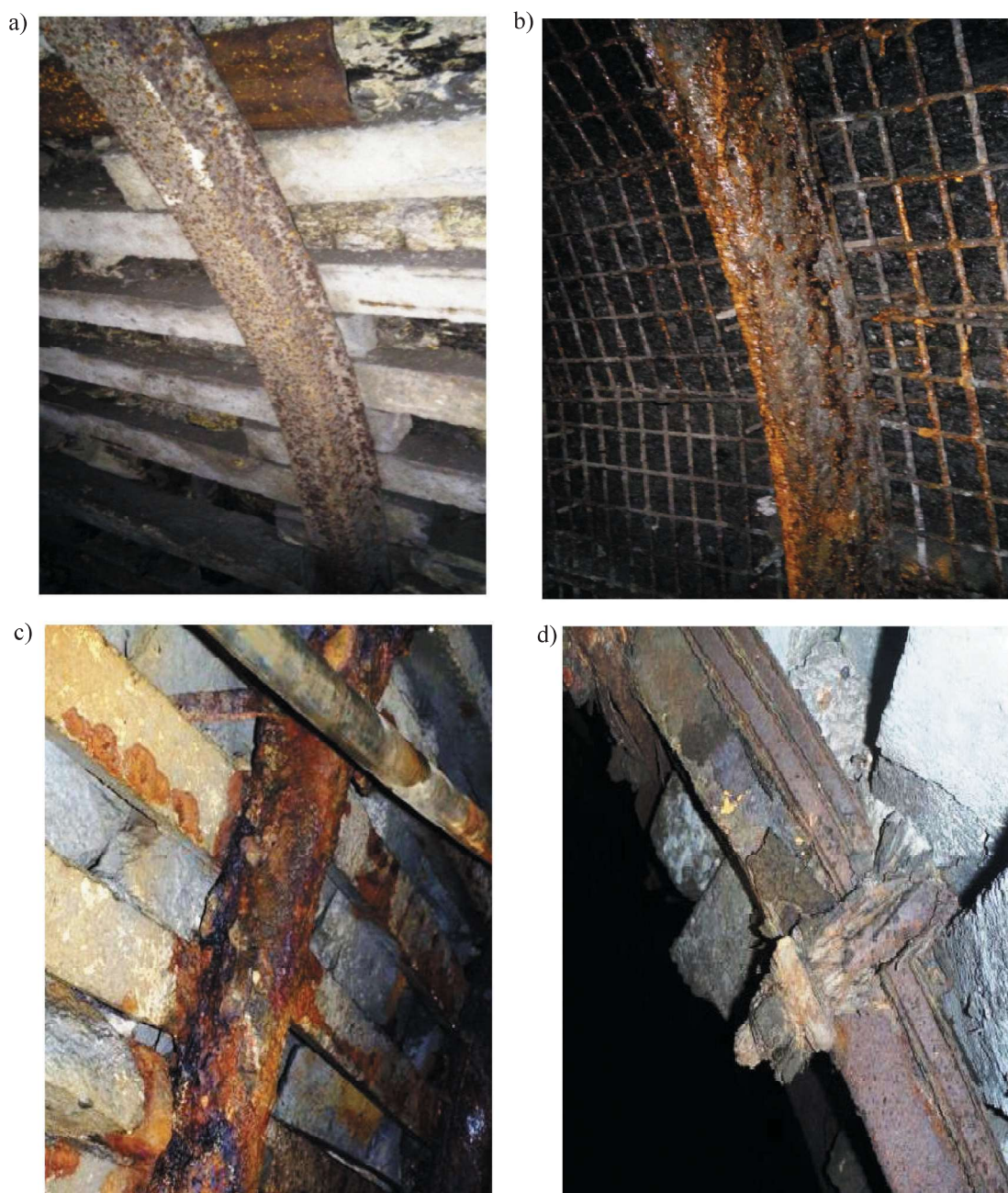
Rys. 2. Przykłady korozji stalowej obudowy korytarzowej w KWK Piast-Ziemowit Ruch Ziemowit (materiał własny): a - poziom I, przekop północny. b - poziom II, chodnik 338, c - poziom II, przekop kołowy P-1, d - poziom III, przekop kołowy C-2.)
