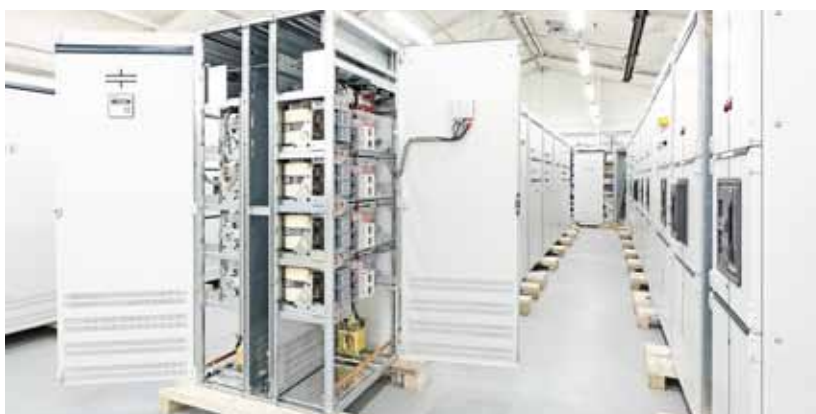
Fot. 1 Rozdzielnice na licencji Siemens SIVACON produkowane przez Elsta
