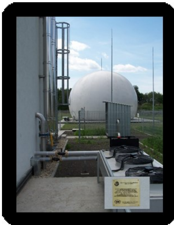
Rys. 4. Instalacja produkcji OZE na terenie Oczyszczalni Ścieków PWiK Rybnik Źródło: www.pwik-rybniki.pl .
