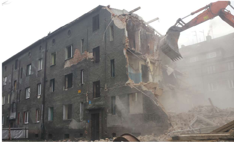
Rys. 6. Wyburzenie segmentu sąsiadującego z analizowanym budynkiem (segment nr 30 – grudzień 2014 rok) Fig. 6. The demolition of the segment adjacent to the analyzed building (segment no. 30 – December 2014)
