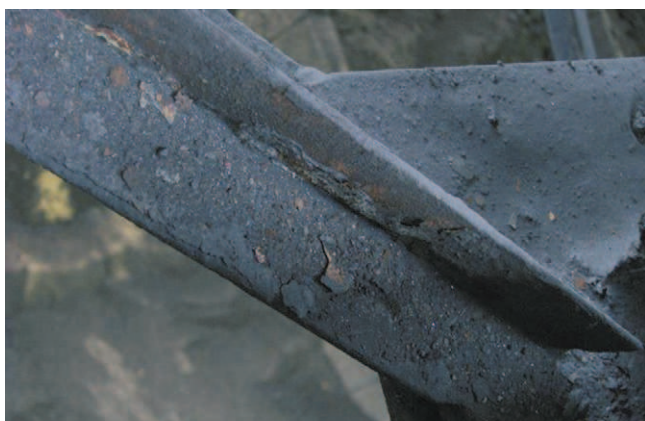
Fot. 2. Ślady korozji i złuszczenia farby na elementach stalowych przy świetliku
