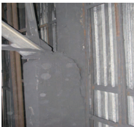
Fot. 3. Uszkodzenia w strefie oparcia dźwigarów stalowych
