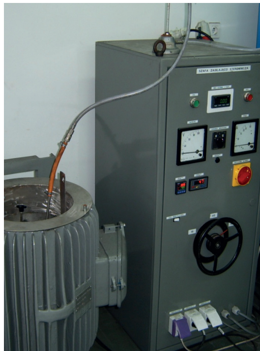
Rys. 8 Urządzenie wraz z szafką zasilającą
