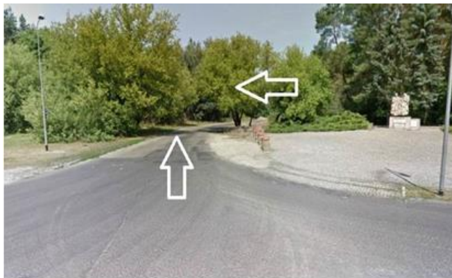
Rys. 14. Roślinność znajdująca się w skrajni drogi na ulicy Kuźnickiej [zdjęcie: autorzy]
