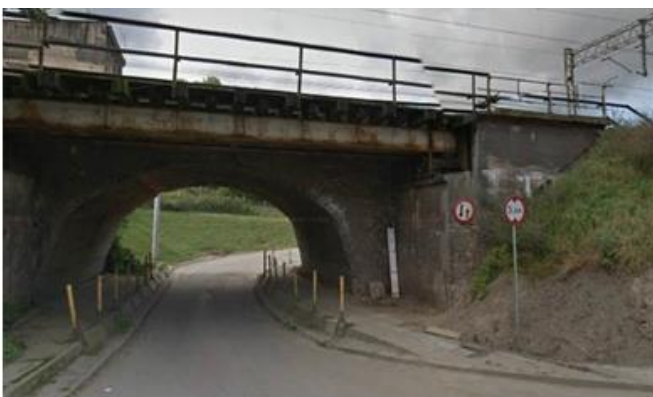
Rys. 17. Przejazd pod wiaduktem kolejowym ograniczony ruchem wahałowym [zdjęcie: autorzy]
