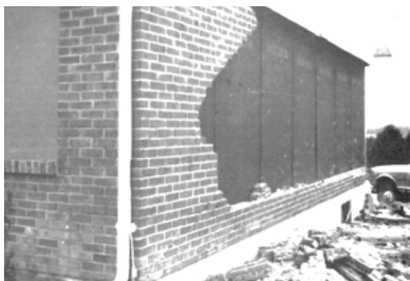
Ryc. 7. Zniszczenia ściany budynku nr 4, położonego około 600 m od epicentrum wybuchu, (na podstawie [2])
