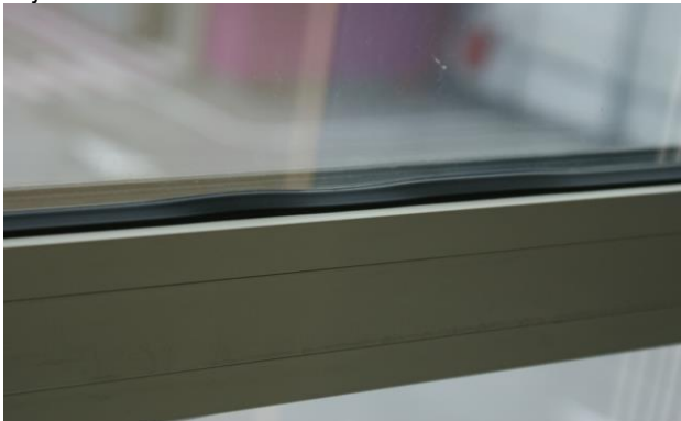
Rys. 11. Widok elewacji w obiekcie użytkowanym, zbyt długa pozioma uszczelka przylegająca niepoprawnie, umożliwiającą swobodny przepływ powietrza.
