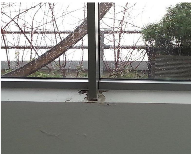
Rys. 8. Zniszczone połączenie konstrukcji elewacji ze ścianą budynku na skutek skraplania się zbyt dużej ilości wody.
