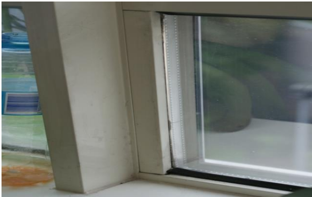
Rys. 10. Widok elewacji w obiekcie użytkowanym, brak uszczelki pionowej.
