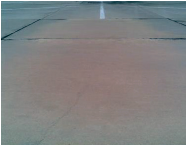
Rys. 1. Widok nawierzchni betonowej poddanej intensywnemu działaniu gorących strumieni gazów spalinowych emitowanych przez samoloty odrzutowe
