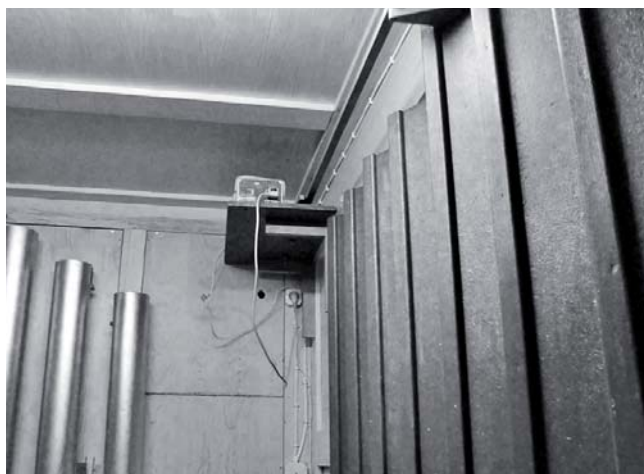
Rys. 6. System napędowy zainstalowany w szafie ekspresyjnej Fig. 6. Electrical drive system installed in the swell box
