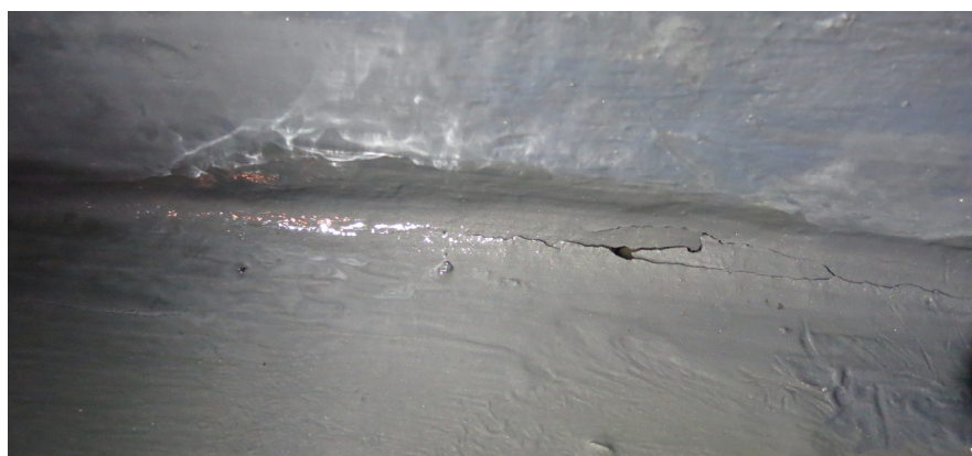
Rys. 3. Pęknięcie warstwy laminatu na styku pomiędzy płaszczem i dnem zbiornika (zdjęcie J. Siudut)
